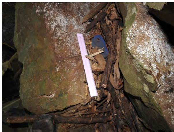
FOTO 171 – PRESENÇA DE DETRITOS VEGETAIS E LIXO CARREADOS POR ENCHENTES FONTE: CONSERV, 2023
