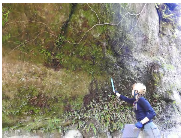
FOTO 121 – RAÍZES E MATERIAL VEGETAL PRESENTE NAS PAREDES E TETO FONTE: CONSERV, 2023
